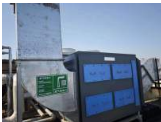
废气处理设施
